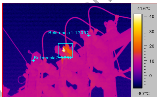
Figura 07. Termografía a Línea Aérea de 23 kV.
